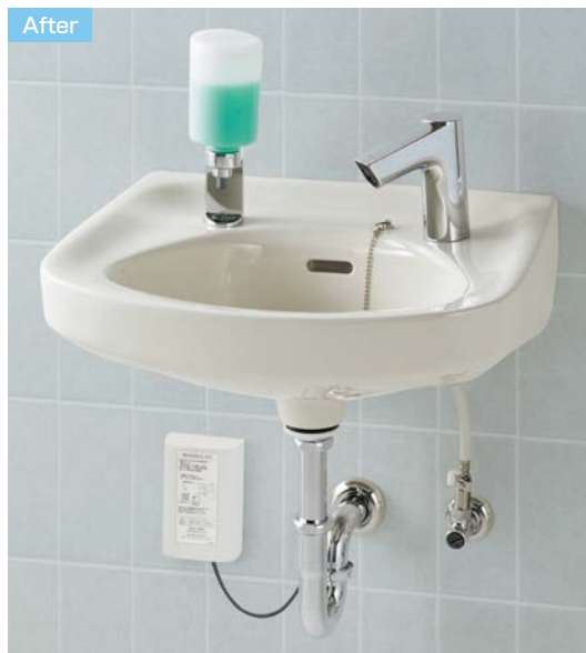
既設の止水栓をそのまま使用しています
